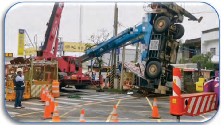
捷運 GC01 工程吊車翻覆
