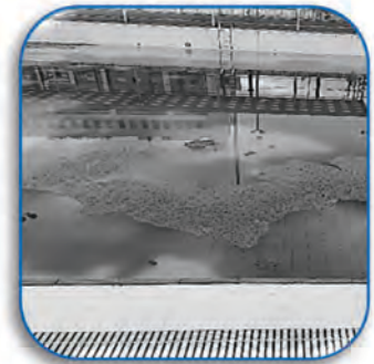
建物水泥層嚴重剝落
