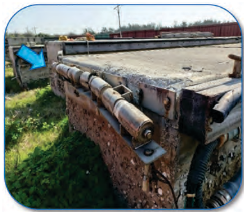
浮箱體連結器損壞現況
