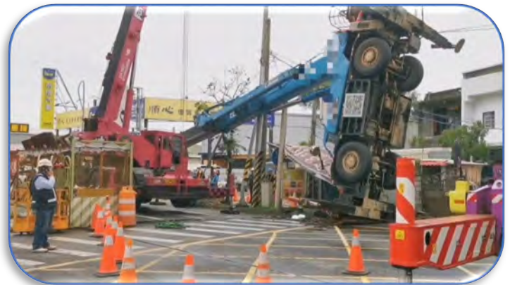
捷運 GC01 工程吊車翻覆
