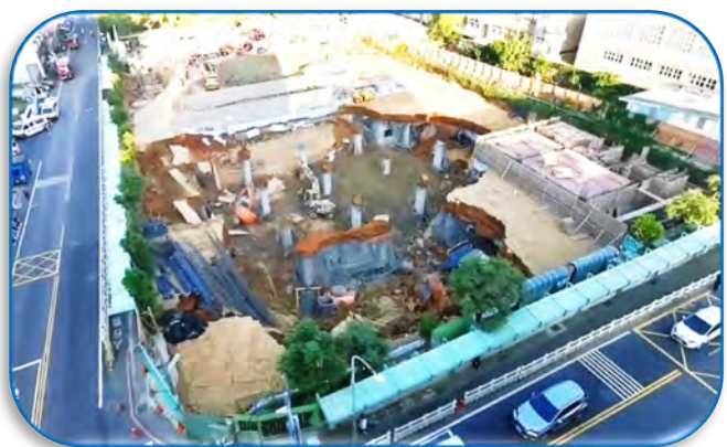
桃園市平鎮區文化公園地下停車場樓板坍塌情形 （圖片來源：交通局提供）
