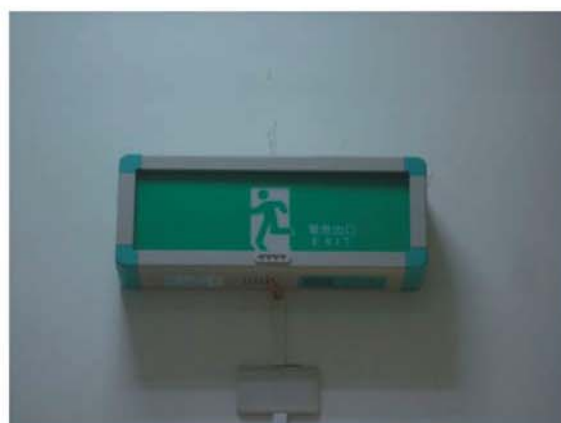
於檔案庫房新增多處緊急逃生指示。
