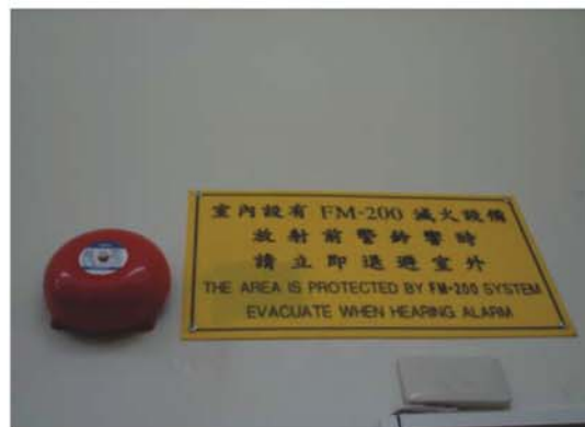
公文檔案室設 FM-200 滅火設備警鈴裝置。
