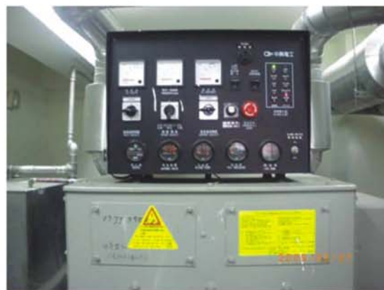
檔案庫房設緊急發電設備，置於大樓地下室。
