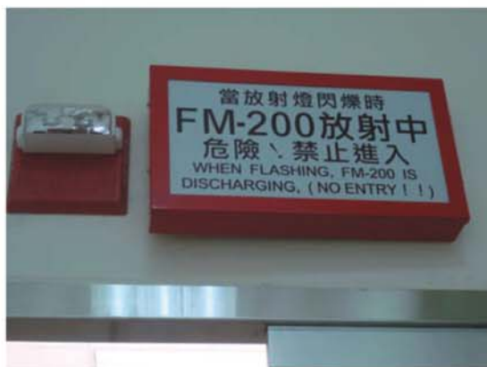
公文檔案室設置 FM-200 滅火設備。
