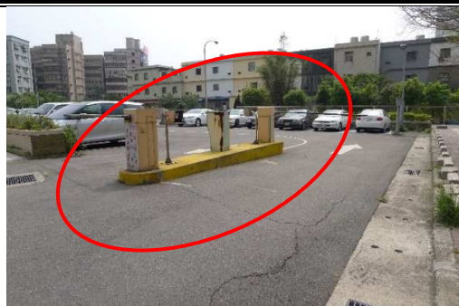
球館右側停車場柵欄機生鏽
