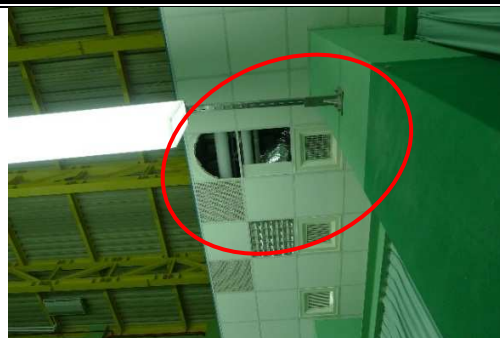
1F 羽球場輕鋼架天花板破損
