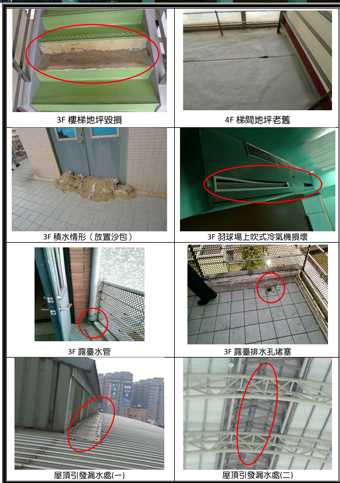
圖 2-3 本場館設施待修繕處
