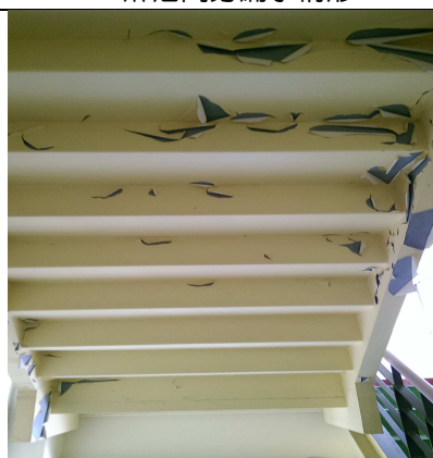
樓梯間牆面需重新油漆
