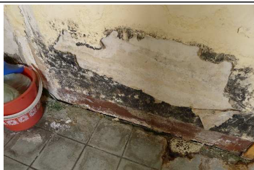
2F 淋浴間旁漏水情形
