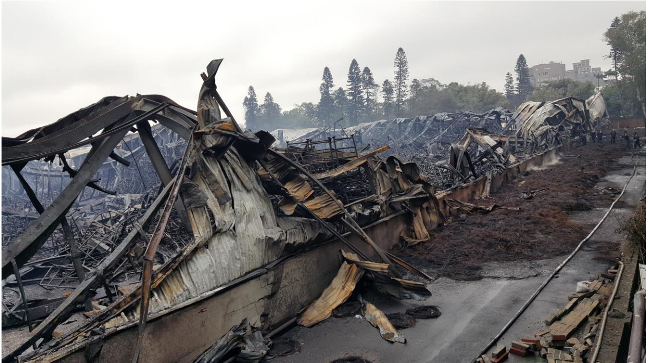
圖一、泰豐輪胎中壢場火災災後照片
