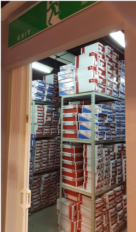
圖四、逃生空間堆置雜物影響避難安全性
