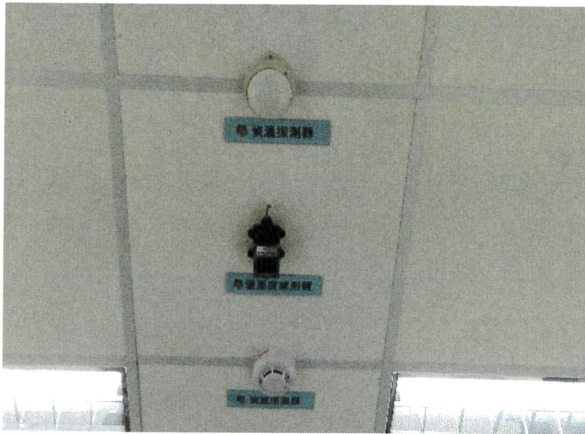
檔案庫房設備有明顯的標示
