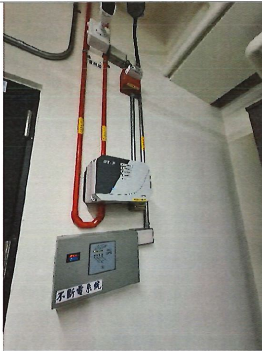
說明：極早期火災預警系統
