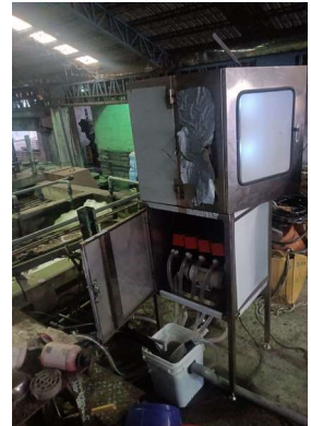
▲ 廢水水質監控系統管線連接
