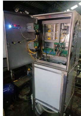
▲ 廢水水質監控系統照片
