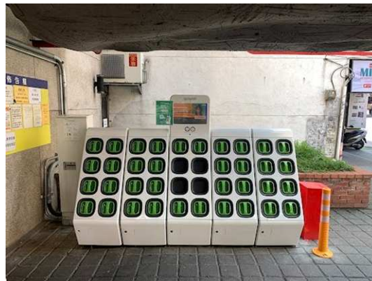
桃園市中壢區延平停車場設置充電設備現況照
