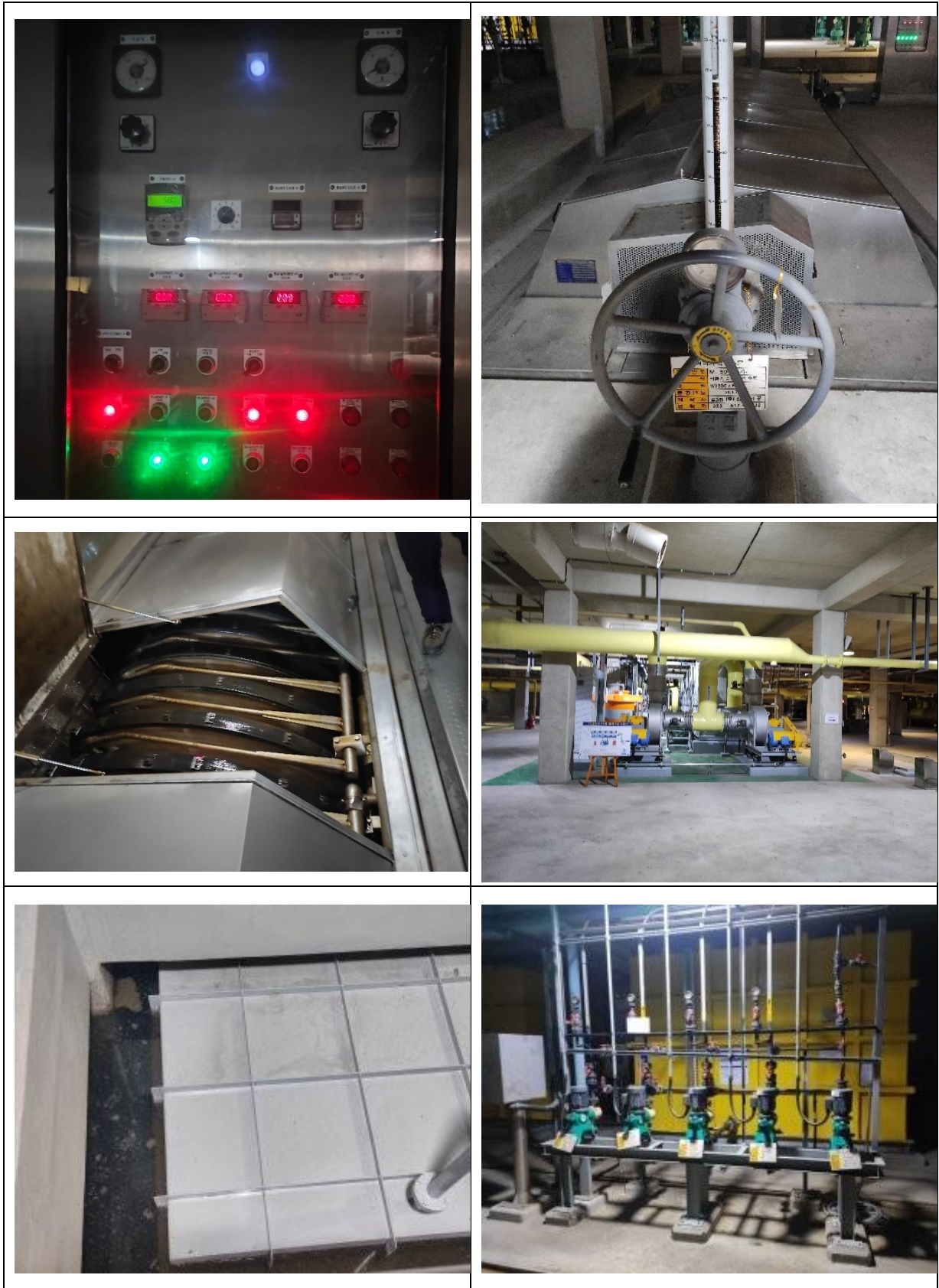
圖 4-4-2、韓國 Saemul Park 地下污水處理廠現場照片
