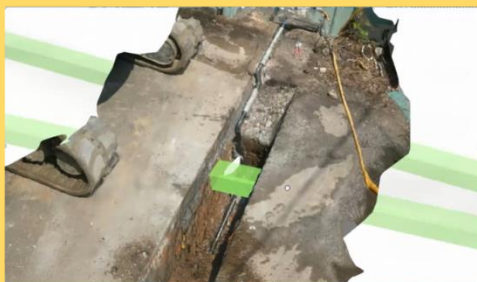
修正前：管線位不正確
