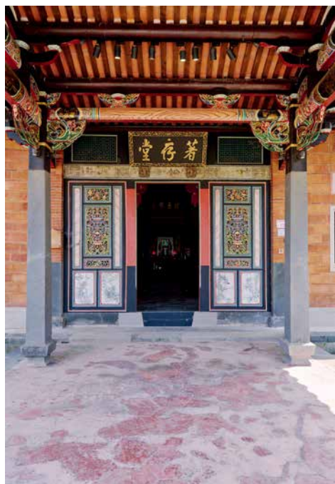
圖6：「著存堂」的軒亭曾因颱風嚴重損毀，直到獲得中央及桃園市政府預算挹注，才得以完成修復工程。
