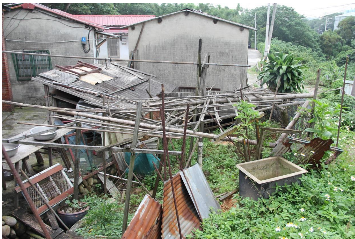
圖 5.6.9 土牛溝東南側尾端被民宅佔用現況
