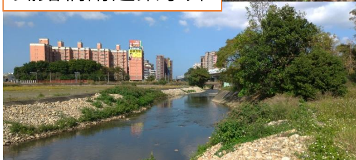
鐵路橋上游左護岸低矮容易溢堤
