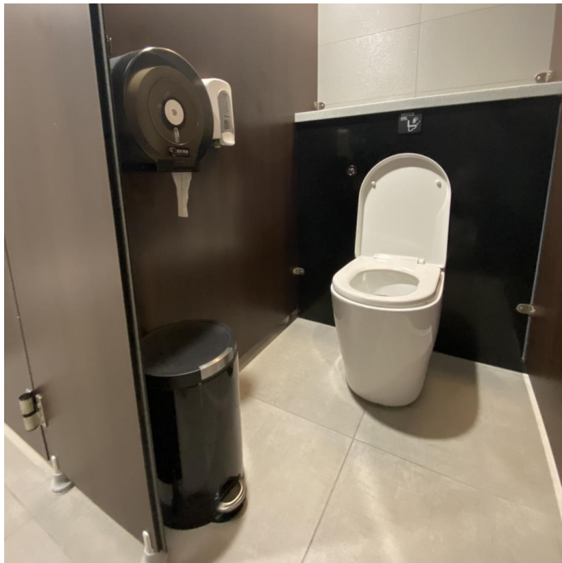
圖 1、本府市政大樓坐式廁間
