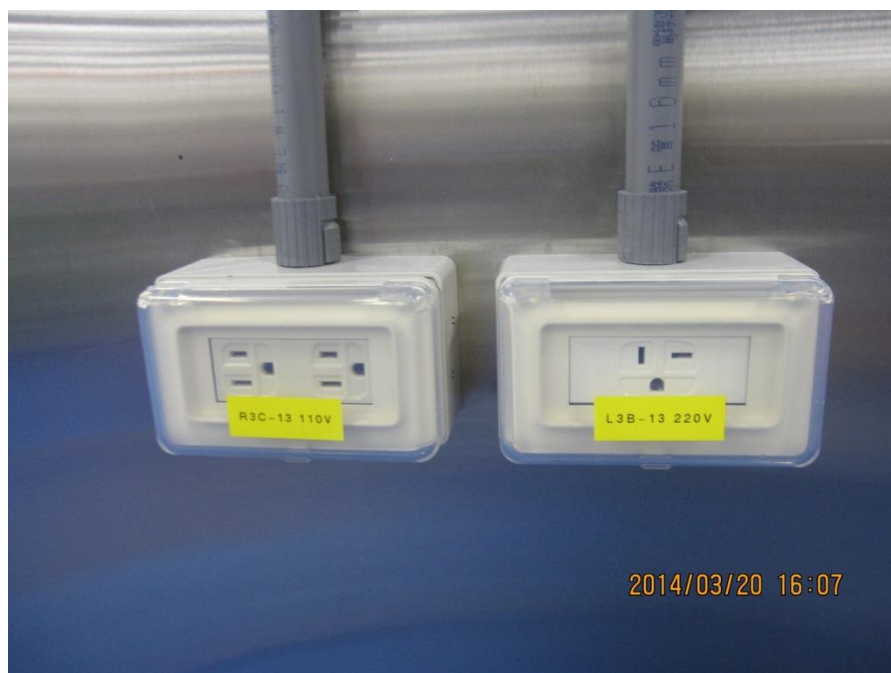
圖 53 工程會扣點編號 5070419 說明：插座迴路及用電電壓標示
