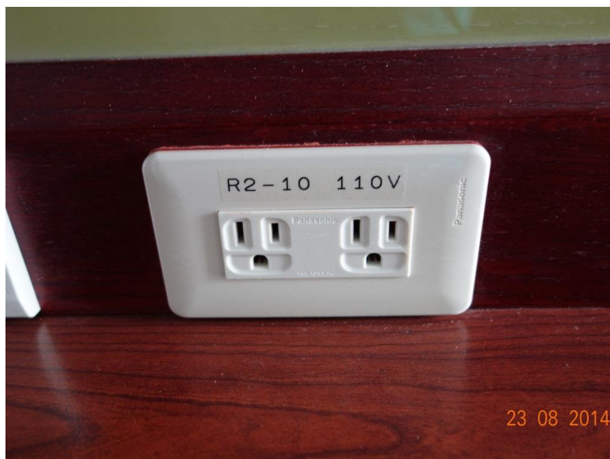
圖 54 工程會扣點編號 5070419 說明：插座迴路及用電電壓標示
