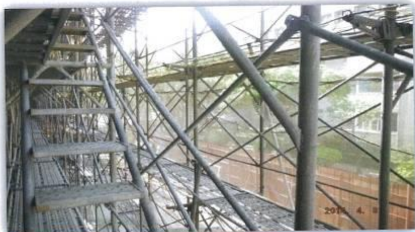
1.5m以上需有安全上下設備
