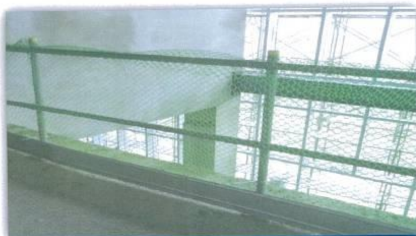
開口護欄高度為90公分以上
