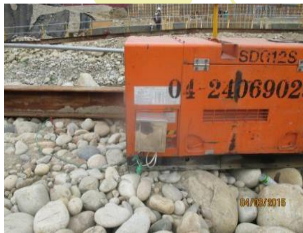
發電機確實接地
