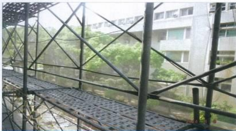
鷹架交叉水平拉桿及踏板
