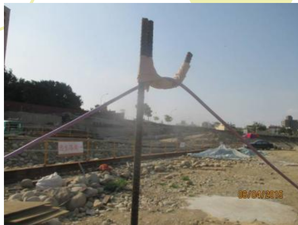
落實電線不落地
