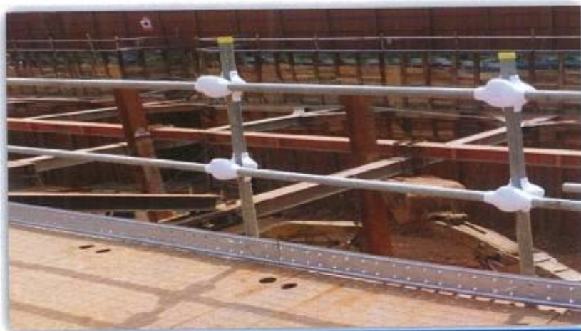
構台四周需設護欄及腳趾板
