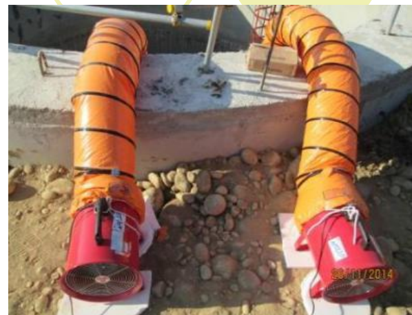
局限空間作業前設置排氣設備
