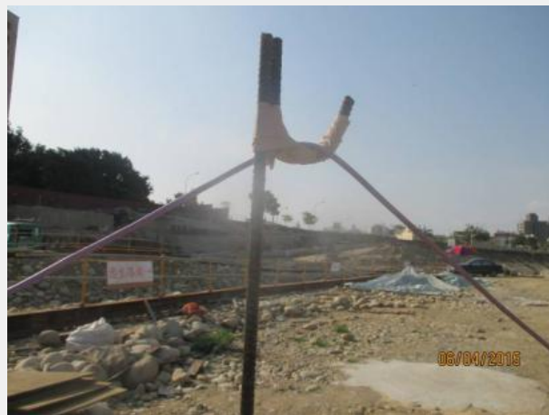
落實電線不落地
