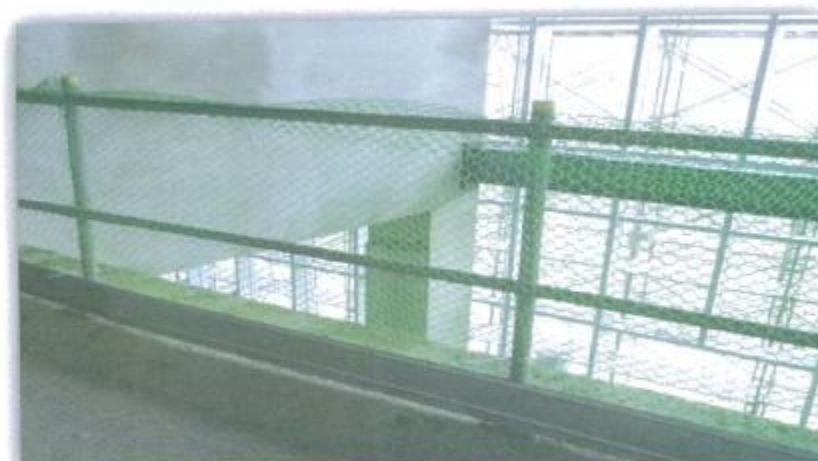
開口護欄高度為90公分以上
