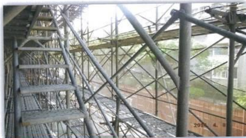
1.5m以上需有安全上下設備
