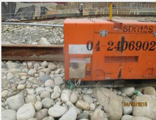
發電機確實接地
