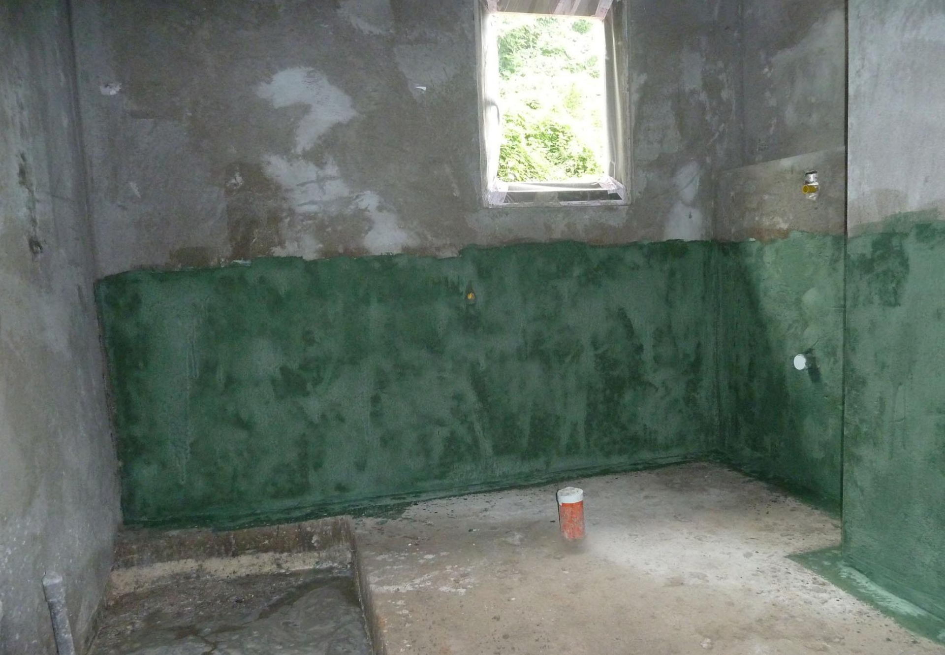
3. 地坪與牆面未施作倒角另防水膜無法確認厚度
