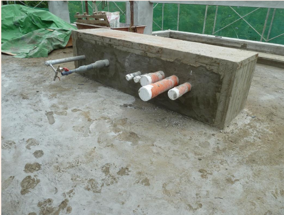
◆管道間未設泛水
