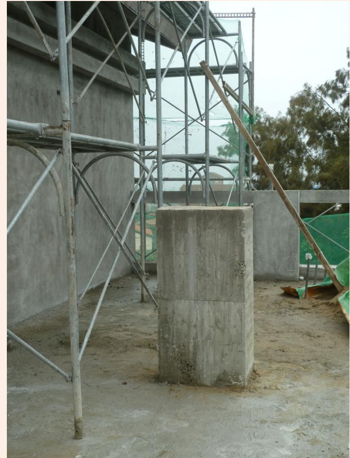
◆預留柱未設泛水
