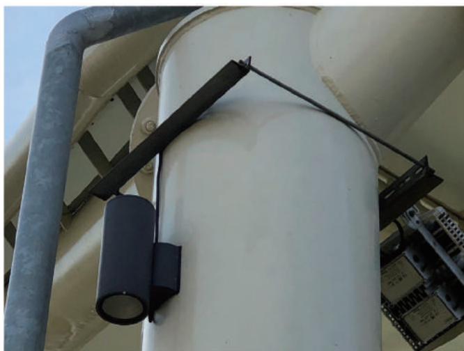
電線線路外露
