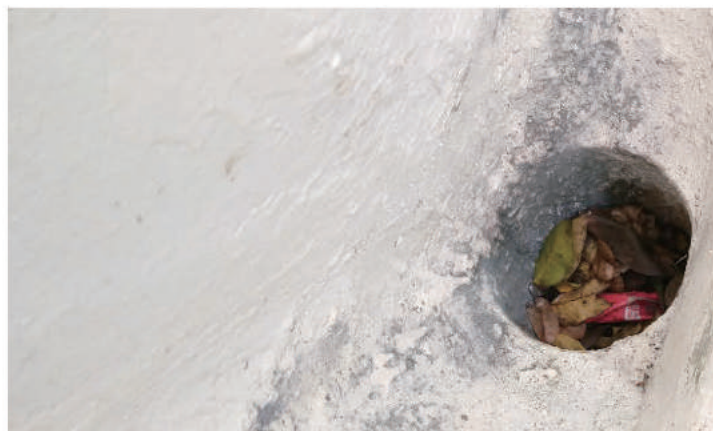
收水孔洞堆積垃圾與落葉
