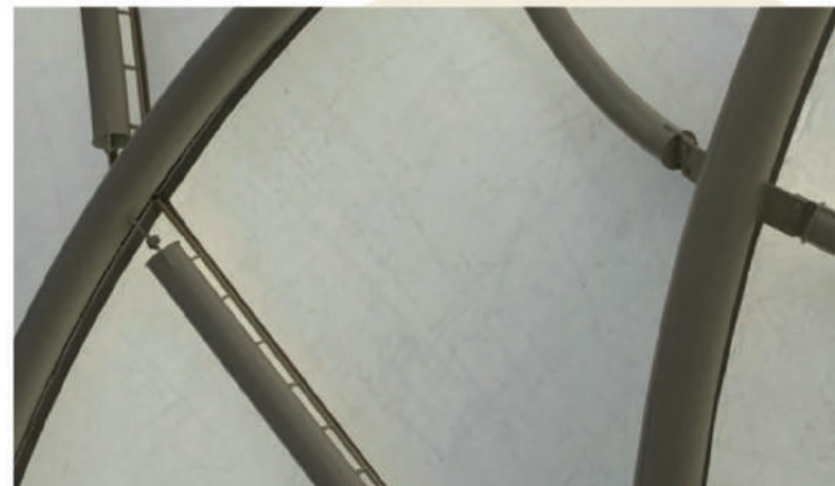
膜材擺放與堆疊不當產生摺痕
