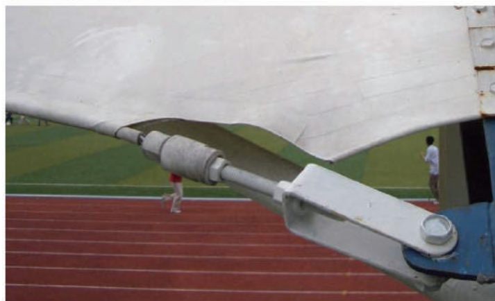
鋼構與固定件未固定牢固造成脫落
