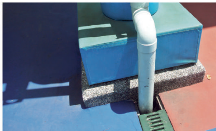
天幕排水銜接至下方排水溝
