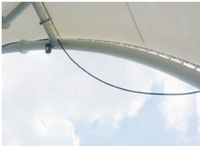
未固定好電線線路懸掛於天幕上
