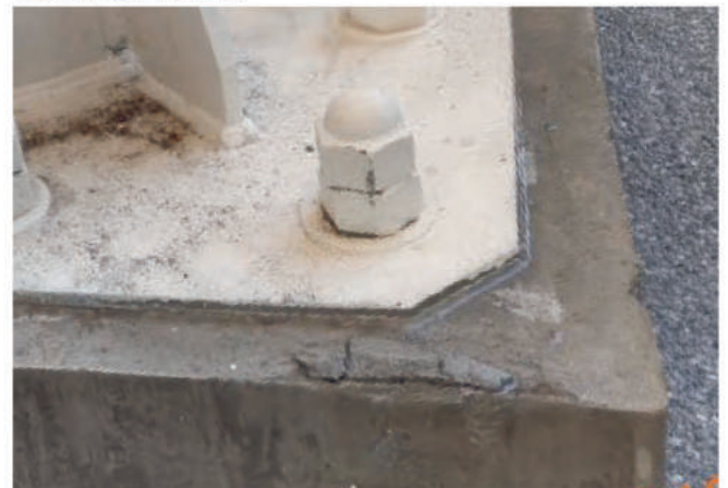
天幕基座混凝土完成面龜裂且未做導角
