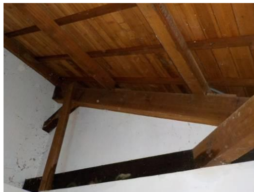
F-2 屋架的陸樑、方丈及吊束有水痕
