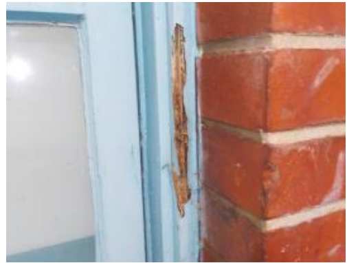
公會堂西側窗框發現蟻道
