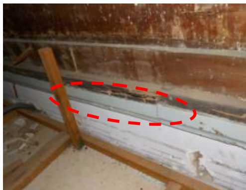
公會堂屋架層數桁發現蟻道
