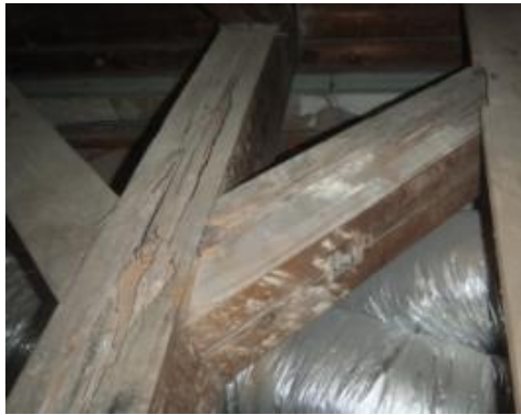
公會堂屋架層第 2 架陸樑及火打發現蟻道
