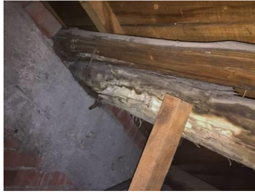
母屋與山牆接觸腐朽嚴重
