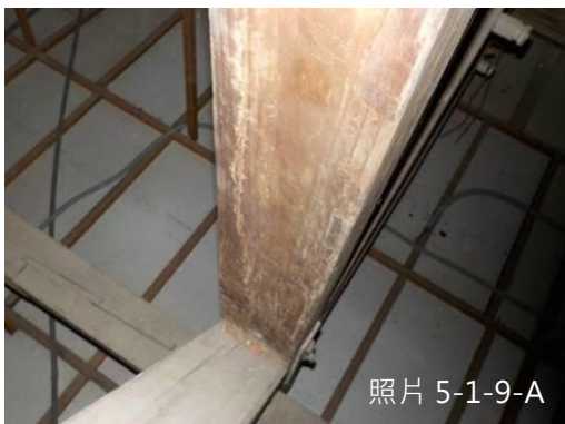
吊束表面有水痕
