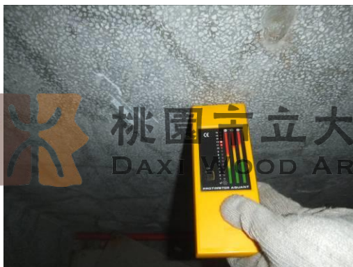
牆體編號 B-29 牆體開裂處量測結果為 13，為潮濕狀態
