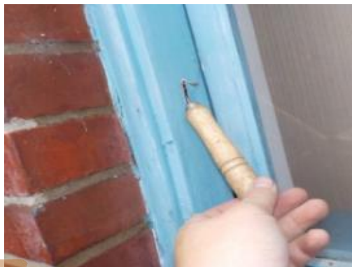
公會堂西側窗框發現蟻道
