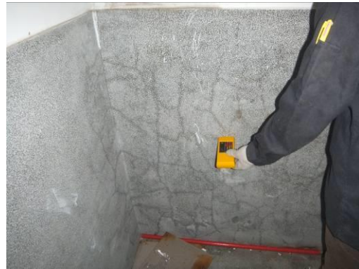
牆體編號 B-29 磨石子牆體開裂
