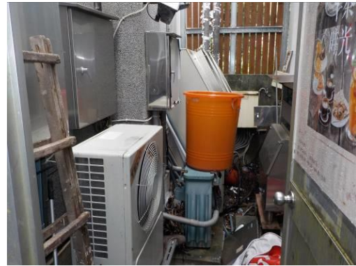
南面南面牆體 ( A-19~A-28 ) 與蔣公行館間堆置大量雜物
