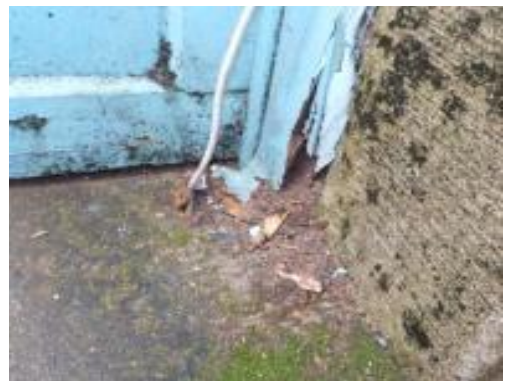
公會堂西側門框發現蟻道
