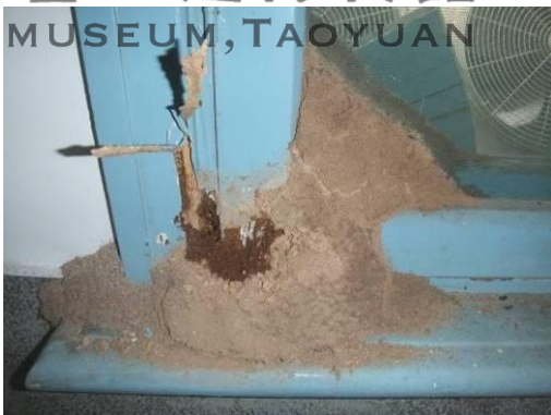
蔣公行館東北側窗框發現白蟻副巢及活體
