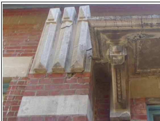
照片 3-2-4-A Art Deco 裝飾風格有破損須修補
