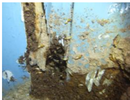
蔣公行館東北側窗框發現白蟻副巢及活體
