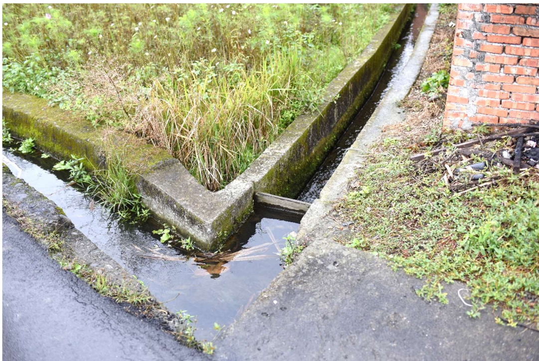
照片 10-11 分水工，水圳為利用重力作用使水流動運輸之系統，而農民如何控制該系統，為重要之傳統智慧
